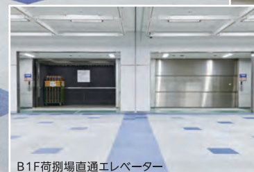
B1F荷捌場直通エレベーター
